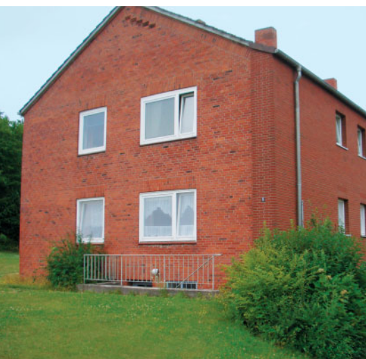
Backstein dämmt nicht mehr genug. Deshalb sollten Wohnanlagen aus den 50er und 60er Jahren schnell energetisch modernisiert werden.
